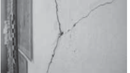
3/16 余震後に病棟内の壁に亀裂(市立病院1号館・4階東病棟)
